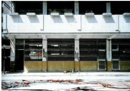
照片 1 窗台旁短柱之破壞
