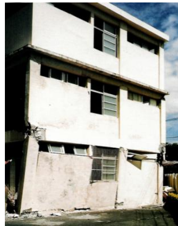
照片 4 廁所高窗旁短柱之破壞
