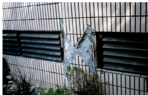
照片 5 地下室高窗旁短柱之破壞
