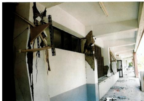
照片 3 高窗旁短柱之破壞
