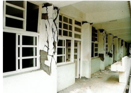
照片 2 窗台旁短柱之破壞
