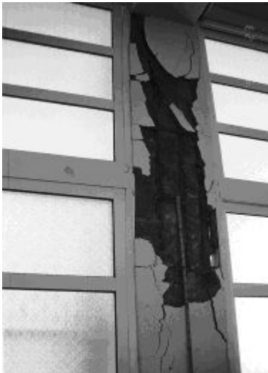
照片 9 柱損害程度為 級。(一層)
