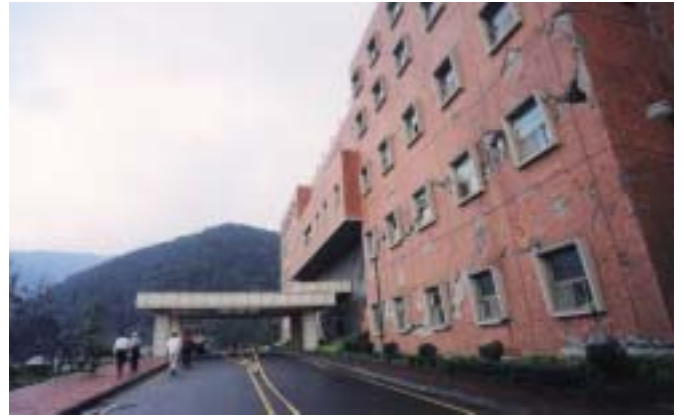
埔里鎮榮民醫院背面受損外貌
