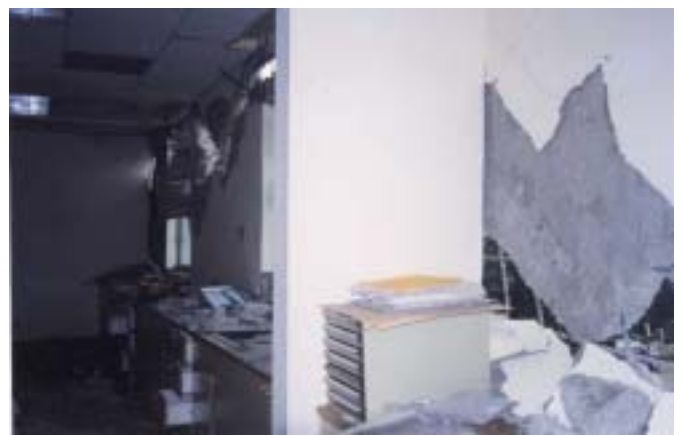
醫院內牆體受損破壞現況
