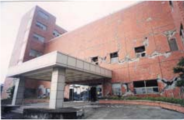
埔里鎮榮民醫院正面受損外貌
