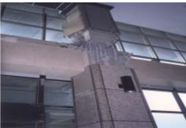
醫院內大廳挑高之樑、柱接頭爆裂
