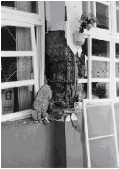
照片 5 柱損害程度為 級。(一層)
