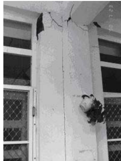
照片 10 柱損害程度為 級。(一層)
