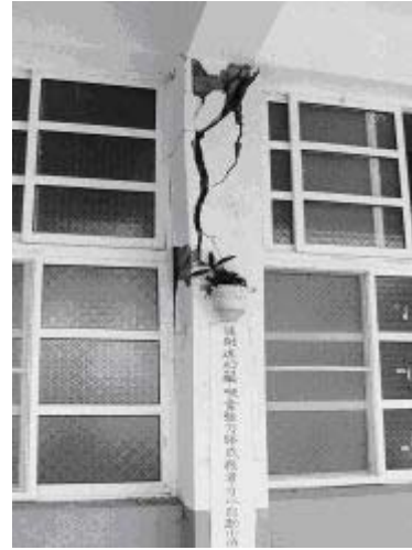
照片 8 柱損害程度為 級。(一層)
