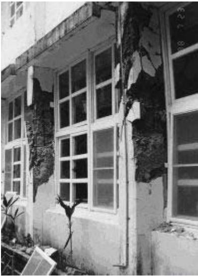
照片 11 柱損害程度為 級。(一層)
