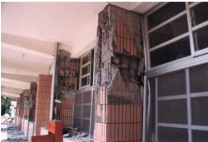
教室前側走廊柱 、 級損壞
