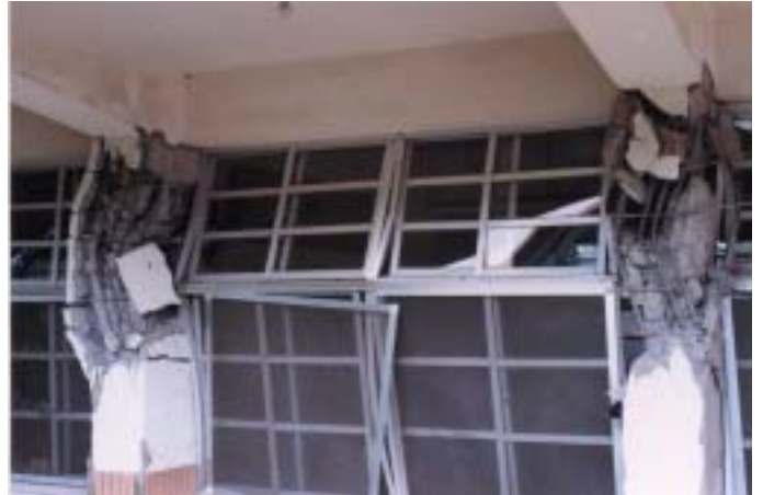
教室走廊柱 級損壞
