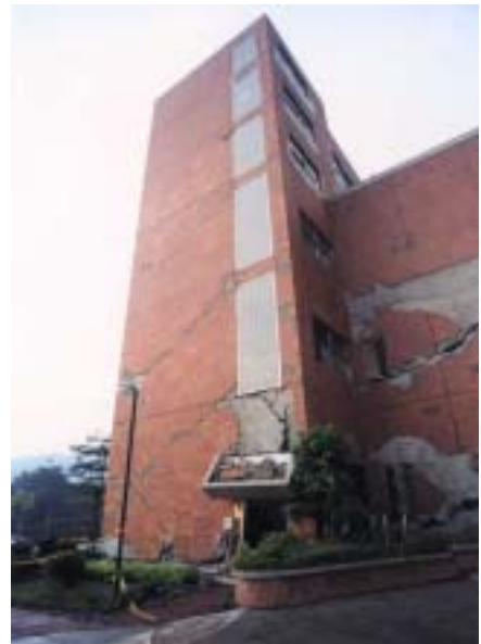
醫院側面梯間外牆斜裂縫及雨庇掉落
