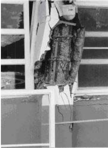
照片 7 柱損害程度為 級。(一層)
