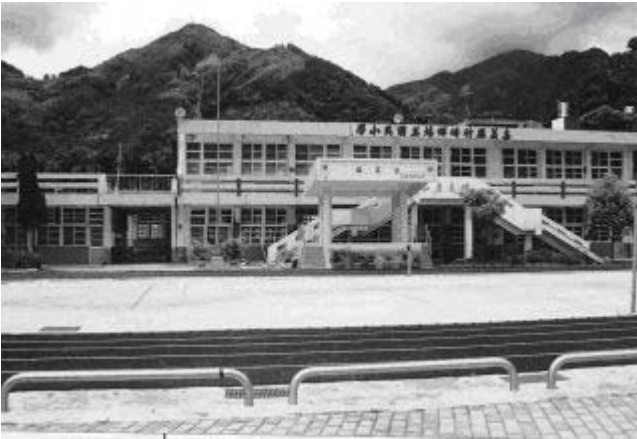
照片 1 培英國小教室之正面外觀，可明顯觀察川堂連接處有相當大之分離現象，整體發生傾斜，其傾斜度超過 1/30，傾斜評估屬嚴重(丙)。
