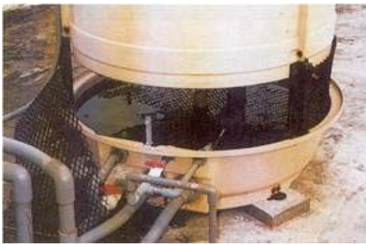
照片 5-9 屋頂空調冷卻塔
