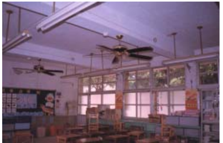
教室靠外側柱(背面) 級損壞
