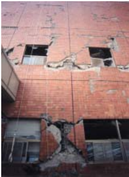
醫院一、二樓因短柱而受損
