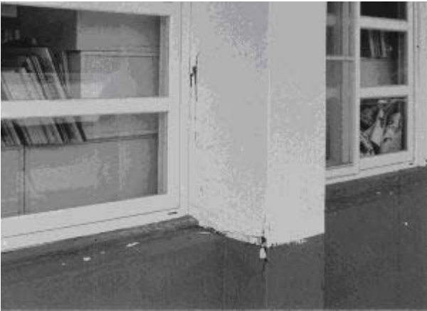
照片 3 由於一層破壞後造成軟弱層，致使二層之破壞程度並不若一層嚴重，此處認為損害程度 級
