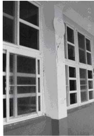
照片 6 柱損害程度為 級。
